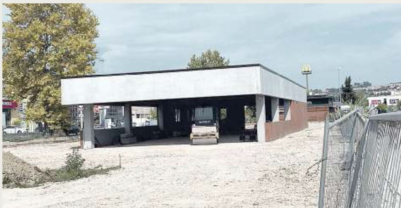
I lavori in corso alla Baraccola per il nuovo locale "Primo piatto"
